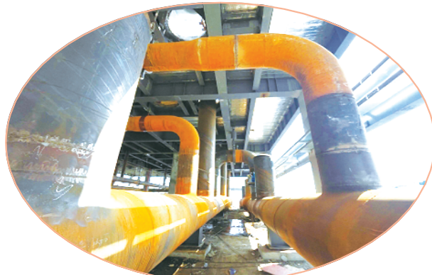
集中供暖首站里的管道。
