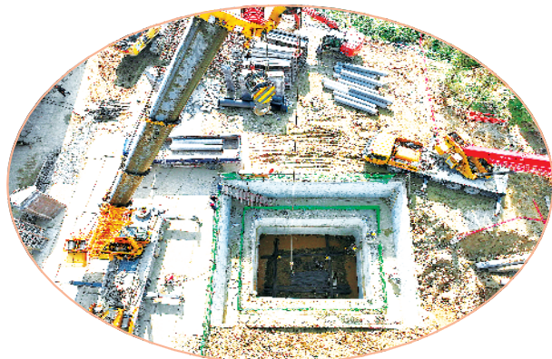
集中供暖管网过沙颍河作业井外观。
