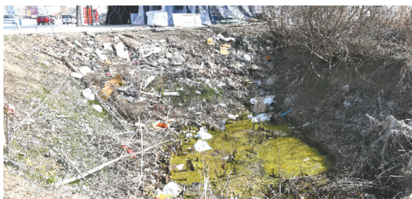
郸城县钱店镇张波楼村220国道东侧新世纪家具批发广场北侧沟内存在乱倒生活垃圾和杂物现象
