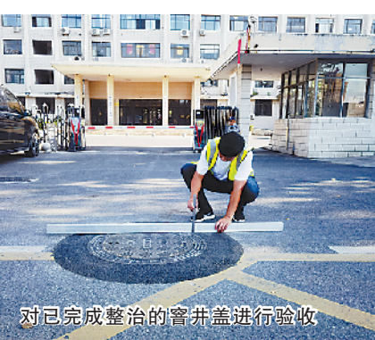
對各縣市區窨井蓋專項整治成員單位現場講解病害窨井設施整治作業步驟
